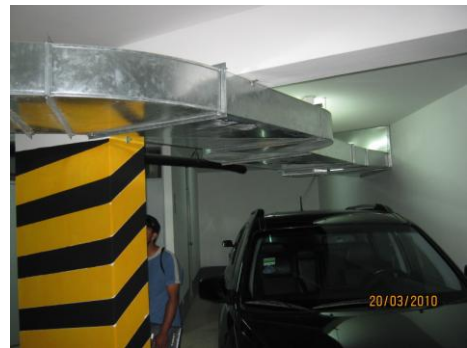
Sistema de extracción de monóxido en edificio en Paseo del Bosque cuadra 11 – San Borja.
